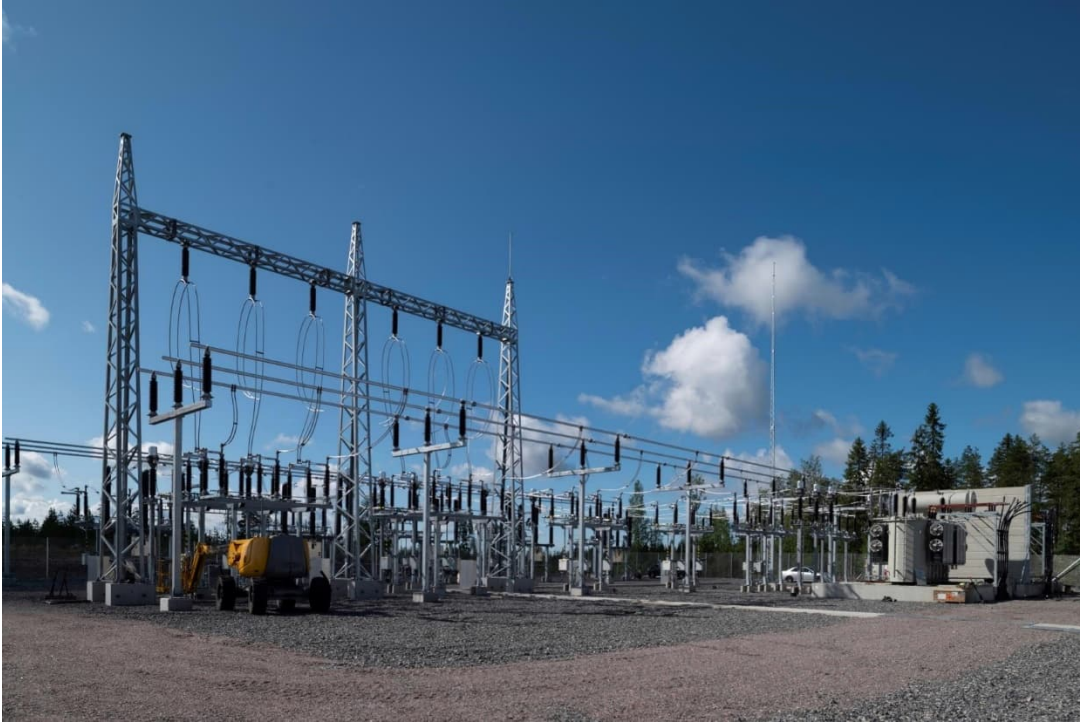
Kuva 2-4- Esimerkki tuulivoimahankkeen sähköasemasta. © Ilmatar Energy Oy.
