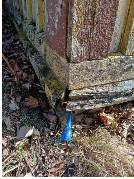
Kuva 26 Länsi/etelä nurkan hirsiseinäessä lahoa. Laho jatkuu länsiseinällä kuistin vasemmalla puolella.
