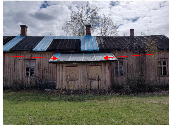
Kuva 2 Rakennus edestä, kuisti kallellaan. Rakennuksessa kokonaisvaltaisesti aaltoilua mm. vesikate. Myös rakennuksessa viitettä painumisesta kuistin kohdalla alaspäin.
