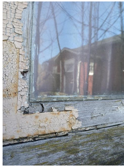
Kuva 24 Ikkunalasien kittaukset kuluneet
