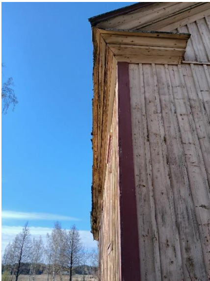
Kuva 52 Räystään laudoitus kauttaaltaan vaurioi- tunut.
