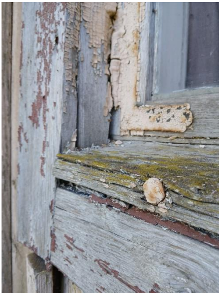
Kuva 23 Ikkunoiden vesipelti- laudat lähes kaikissa ikkunoissa uusimistarpeessa lahoamisen ja halkeilun vuoksi
