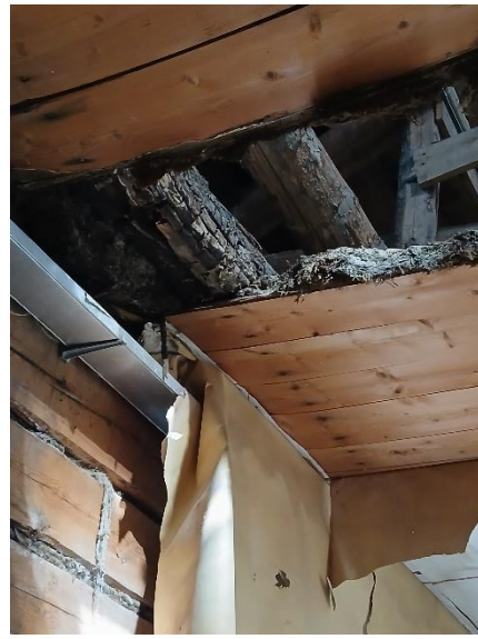
Kuva 37 Vaurioita kantavissa rakenteissa
