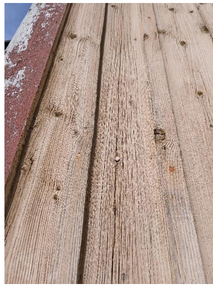
Kuva 20 Verhouksen kunto laajalta osalta halkeillut ja vääntyillyt erityisesti etelän ja lännen sivuilla
