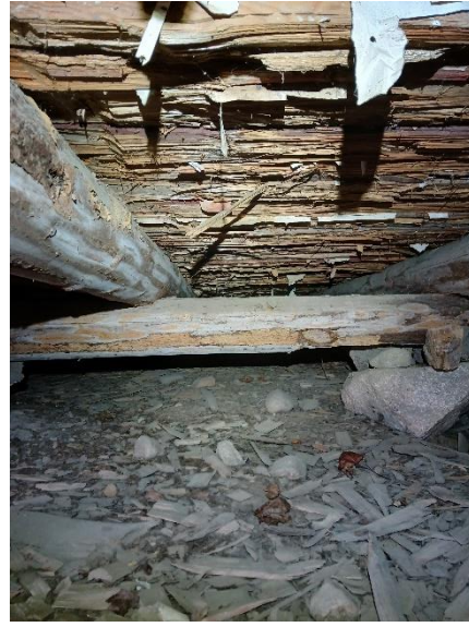
Kuva 8 Alapohjarakenteen alapinta päreentynyt. Palkeissa ei lahoa, mutta vaaleaa aistinvaraisesti mikrobiperäistä jälkeä.
