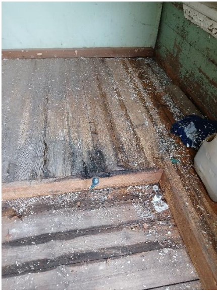
Kuva 42 Kuinon lattiapinta märkä ja osin lahoa.
