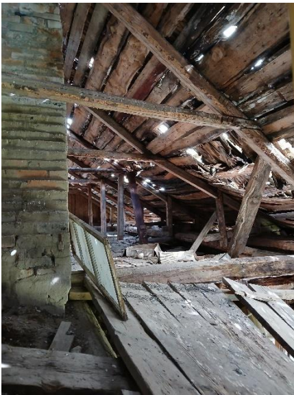
Kuva 56 Katteessa rikkoumia koko lappeen matkalla ullakolla.
