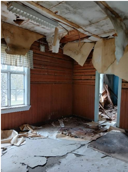
Kuva 38 Kattovuotojen aiheuttamia vaurioita
