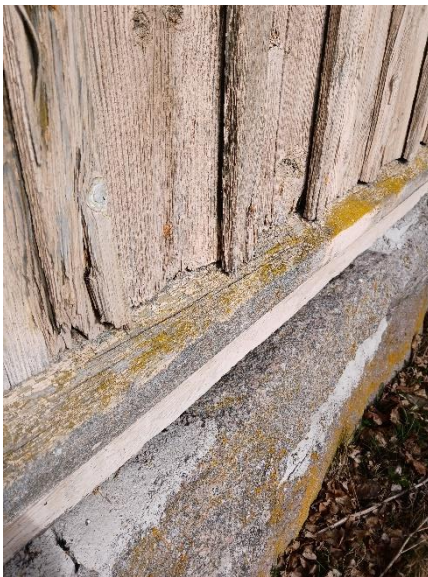
Kuva 19 Puuverhouksen alaosat ovat kauttaaltaan kuluneet
