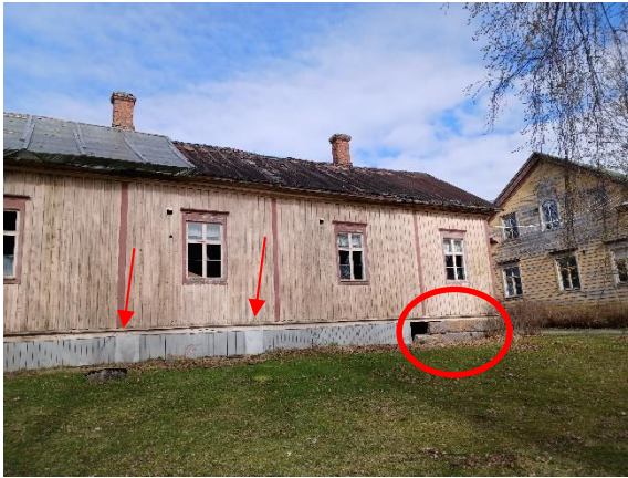
Kuva 1 Rakennus takaa. Jälkikäteen valetut betoniset tukipilarit osoitettu kuvassa nuolilla. Rikkoutuneen sokkelin sijainti esitetty ympyröimällä.
