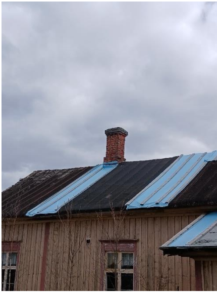
Kuva 46 Etupihan puolella hätäkorjauksia. Päädyssä harjalla huopa myös kulunut ja päreet näkyvillä.
