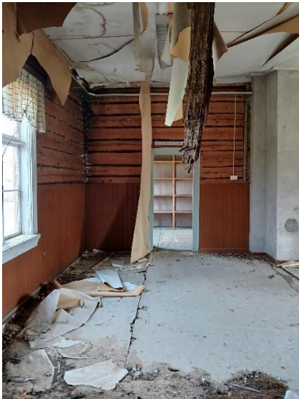
Kuva 40 Osin hirsi näkyvillä- väliseinähirren yläosissa sadevesien aiheuttamaa tummentumaa
