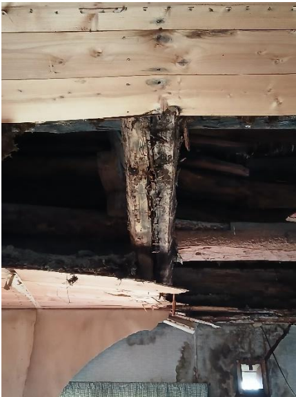
Kuva 36 Kosteusvaurioita kantavissa rakenteissa
