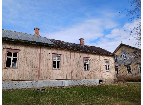
Kuva 51 Katetta peitetty pahimmilta kohdin- katteella näkyvissä muitakin vauriokohtia
