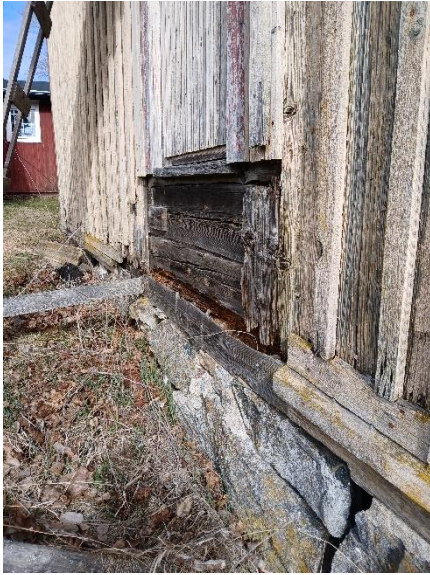
Kuva 25 Hirsiseinä näkyvillä eteläpäädyssä. Alin hirsi lahovaurioitunut noin puoleen väliin hirttä.
