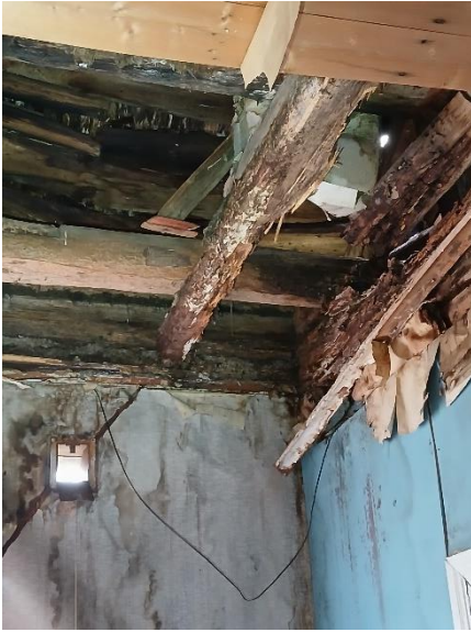
Kuva 34 Kantavissa palkeissa vaurioita
