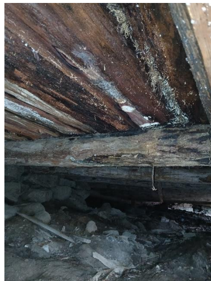
Kuva 10 Kattovuodon kohdalla alapohja kastunut alapintaa myöden
