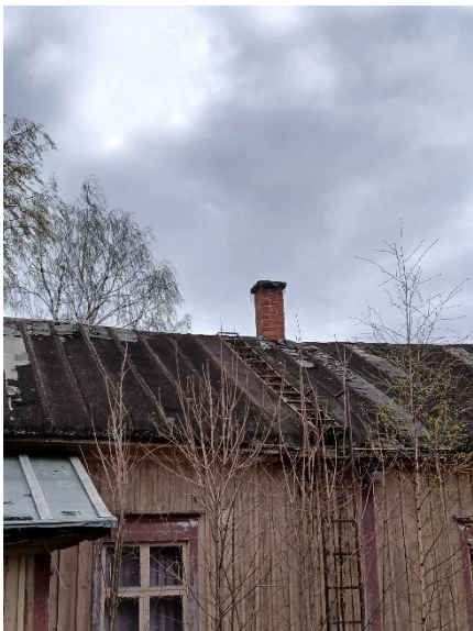
Kuva 48 Katteessa aaltoilua, joka aiheutunut kantavien rakenteiden vaurioista.
