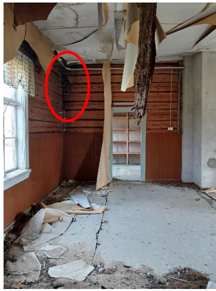
Kuva 32 Kattovuodot kastelee nurkan yläosan hirsirunkoa ulko + väliseinä
