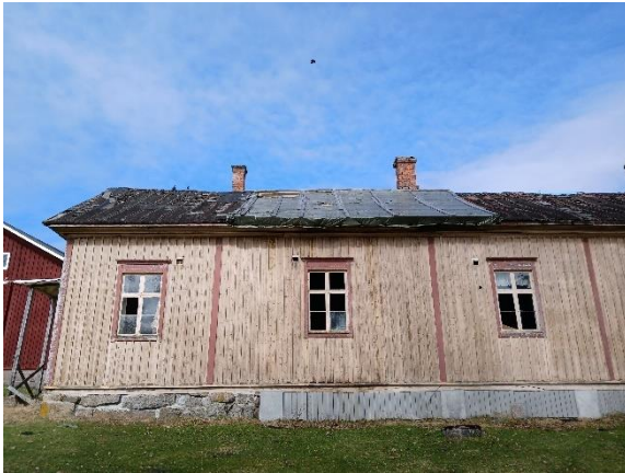
Kuva 50 Katetta peitetty pahimmilta kohdin- katteella näkyvissä muitakin vauriokohtia
