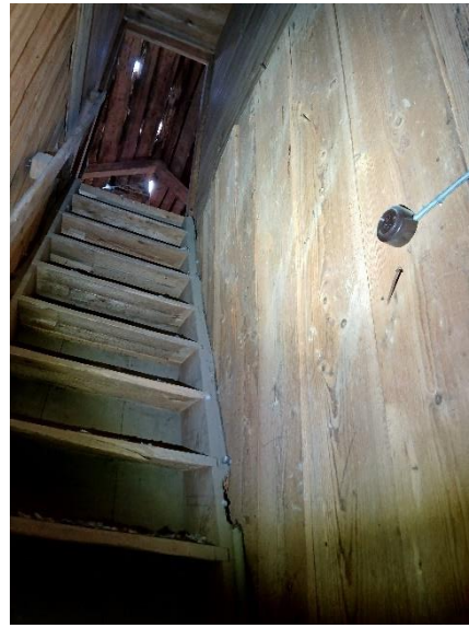
Kuva 45 Ullakkoportaiden seinä pullistunut
