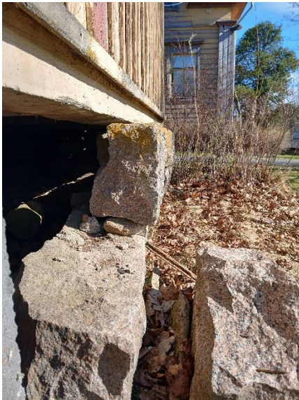
Kuva 3 Päärakennuksen kiviladelman sokkelissa kallistumaa, jonka vuoksi kiviä sortunut.
