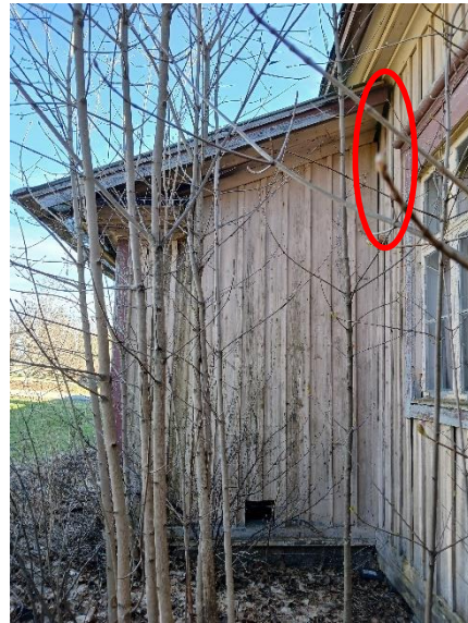
Kuva 4 Kuistissa havaittavissa kallistumaa, muodostunut rako kuistin ja päärakennuksen seinän välille.
