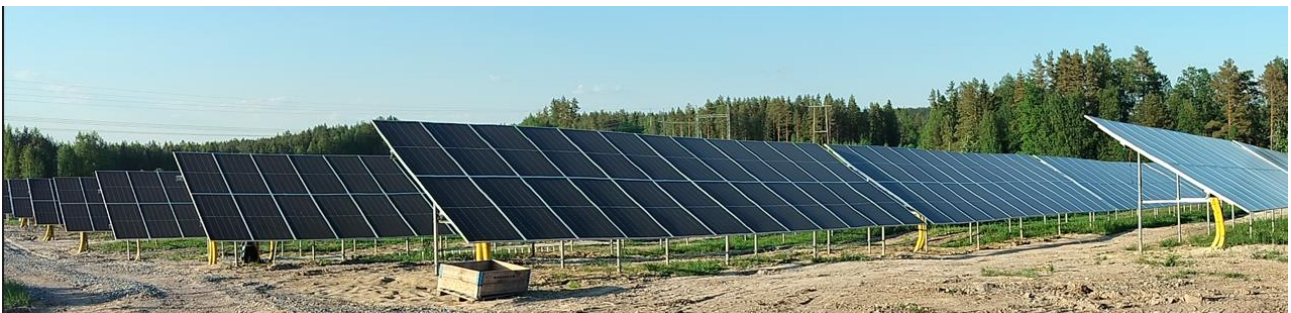
Kuva 2: Aurinkopaneeleita. Kuva: T. Järvinen 2024
