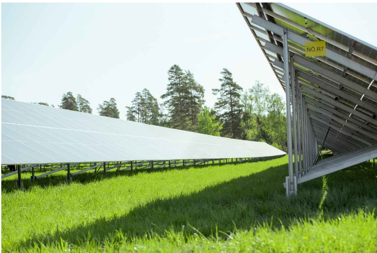
Kuva 4. Aurinkopaneelit asennetaan pitkiin riveihin, joiden välinen etäisyys on noin 5–6 metriä, ja ruoho sekä muut kasvit voivat kasvaa paneelien alla. Maa-alueita ei siis päällystetä, mikä mahdollistaa huleveden imeytymisen maaperään.
