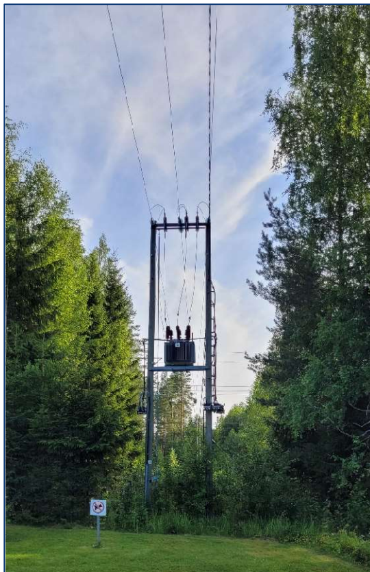
Kuva 6. Pylväsmuuntamo Teikankaan pohjavesialueella kesällä 2024.
