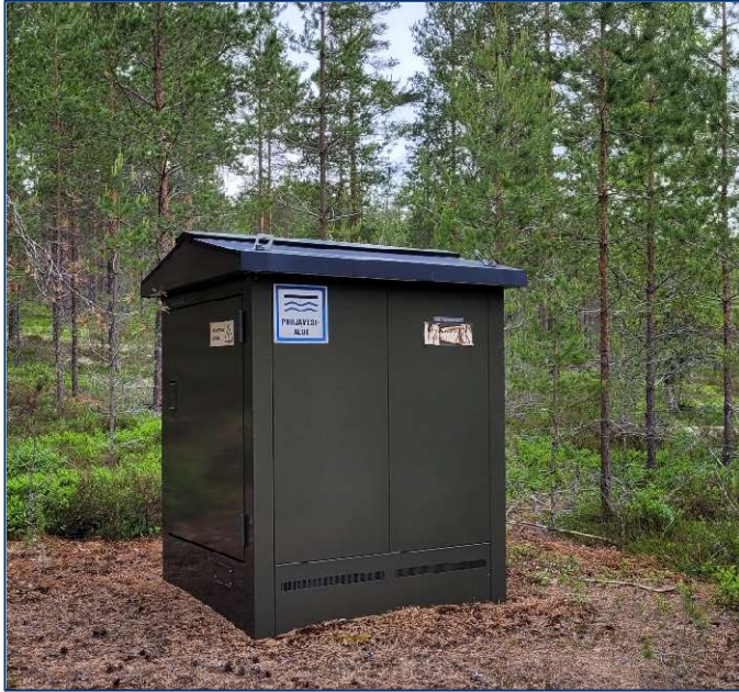
Kuva 5. Puistomuuntamo Vatulanharjulla kesällä 2024.
