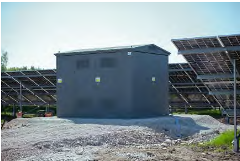
Kuva 6. Esimerkki aurinkovoimapuistoon sijoitettavasta muuntamoasemasta. Lähde: Helios Nordic Energy AB aurinkovoimapuisto Kungsåra.
