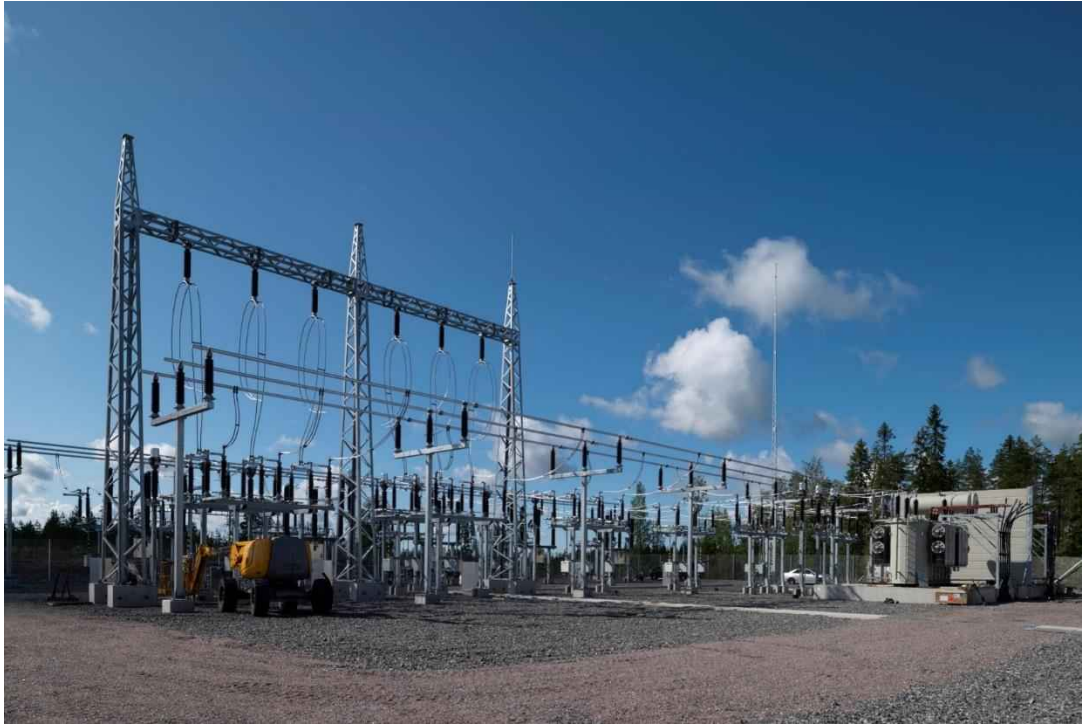
Kuva 5-5. Esimerkki tuulivoimahankkeen sähköasemasta. © Ilmatar Energy Oy.
