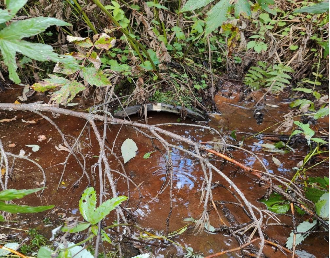
Kuva 2.2. Kuvaan 2.1 punaisella merkityssä kohdassa Kylmäojan laskeva sivu-uoma oli lähes kuiva ja tien alittava putki pahoin tukossa.
