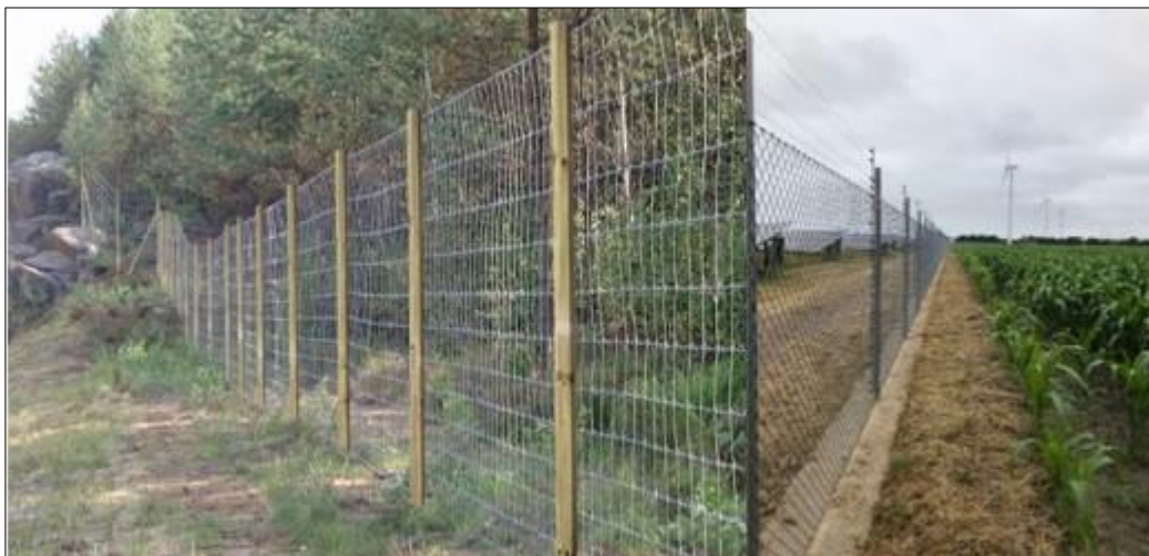
Kuva 2. Esimerkki riista-aidasta puutopilla (kuva vasemmalla) ja teollisuusaidan toteutuksesta, jossa on sisäpuolinen ylityssuojaus sähkölangoin (kuva oikealla).
